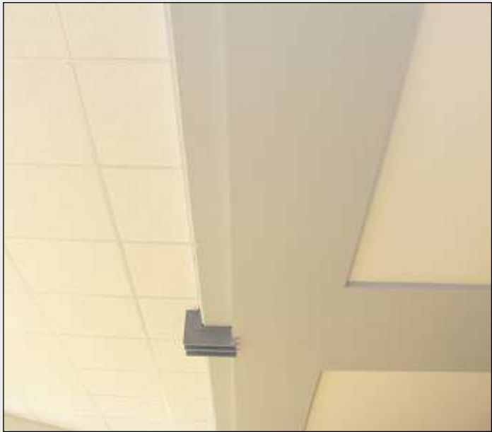
Die Schnittstelle von altem Gebäude und neuem Anbau ist an der Decke ersichtlich.
